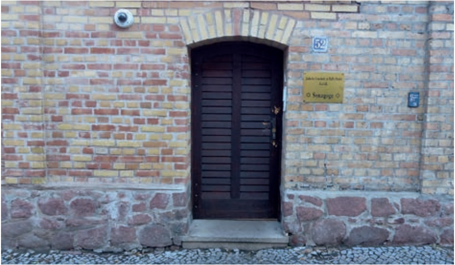
Die beschädigte Tür der Synagoge von Halle | Foto: Amadeu Antonio Stiftung
